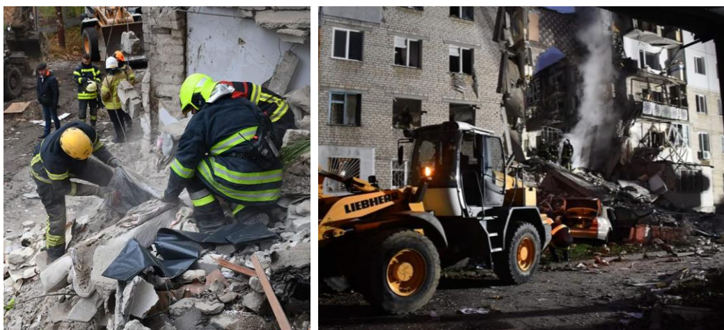
Рис. 3. Проведення пошукових та АРР на зруйнованих будівлях
